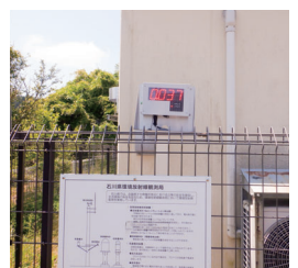
環境放射線観測局表示装置（七尾市西岸局）
