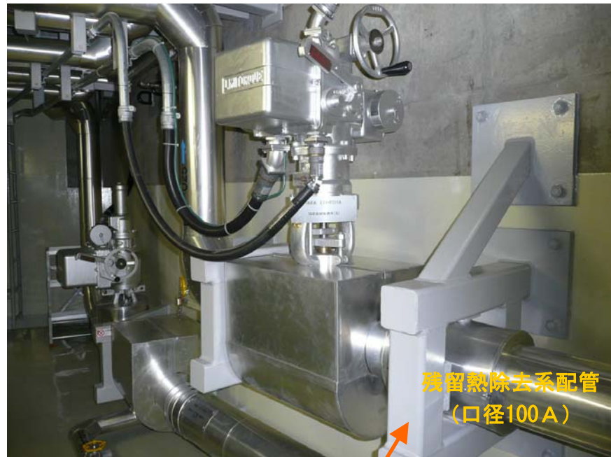
残留熱除去系配管
