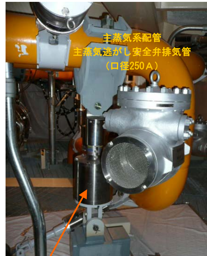
主蒸気系配管
